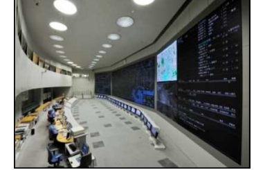
交通管制センター
