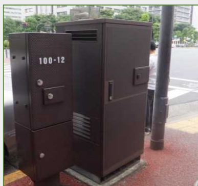
信号機電源付加装置(自動起動式発動発電機)
