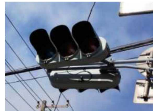
滅灯した信号機の状況
