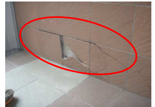
警察学校 壁崩落の状況
