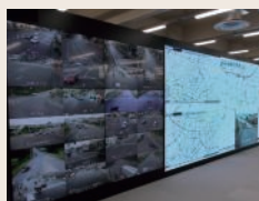
交通管制センター
