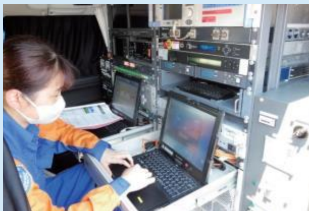
応急通信対策車の衛星設備での 映像伝送訓練
