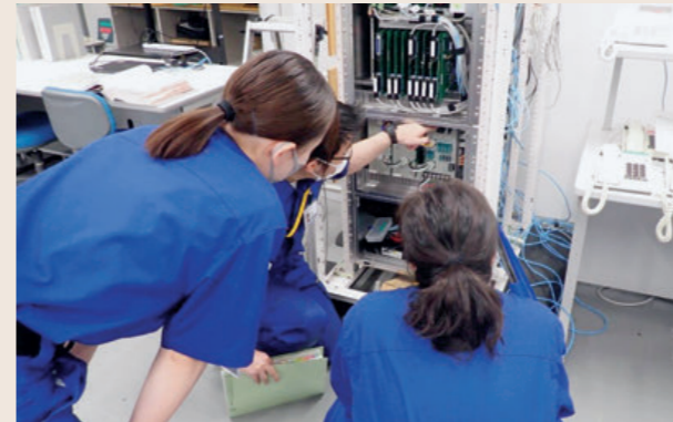
実機を用いた通信システム実習
