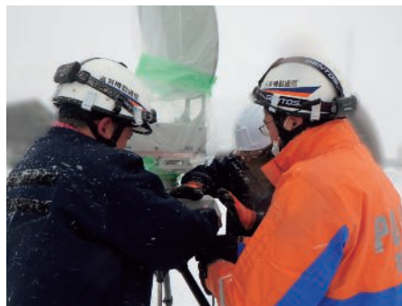
ヘリコプターテレビシステムの受信設備の臨時設置状況
