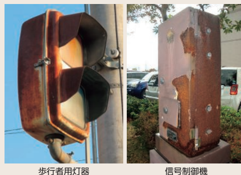
図表4-35 老朽化した交通安全施設
