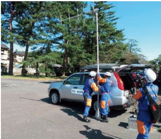
臨時無線中継所の設置状況
