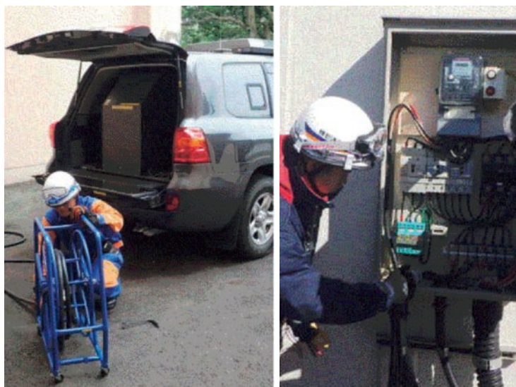
非常用電源車から無線中継所への電源供給訓練
