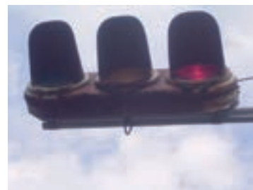
整備後長期間が経過した信号機
