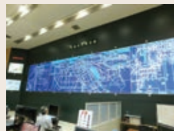
交通管制センター
