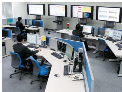
リアルタイム検知ネットワークシステム
