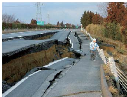
常磐自動車道水戸 IC～那珂 IC 間での路面の陥没と波打ち
