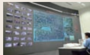
交通管制センター
