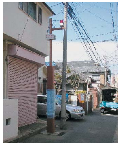
子ども緊急通報装置
