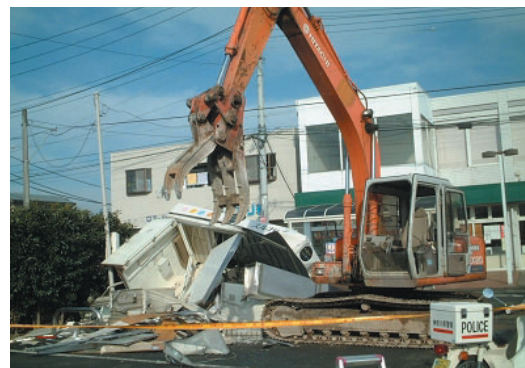
建設機械により破壊されたATM機
