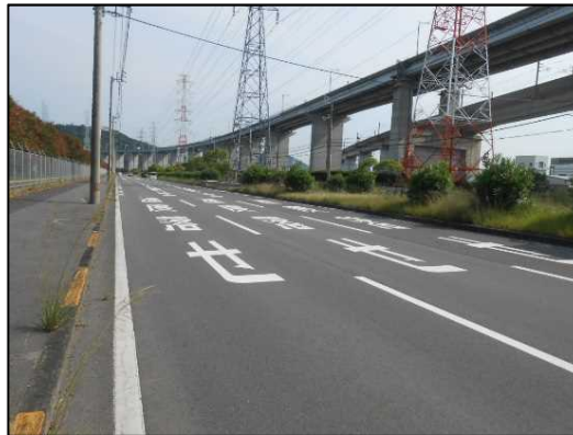
「速度落せ」の法定外表示
