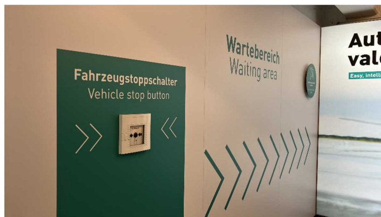
図 19 緊急停止ボタン
