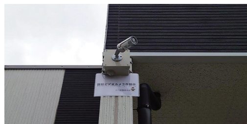
▲防犯カメラの設置状況
