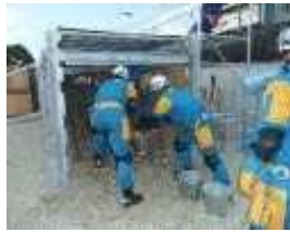
土砂埋没建物ユニット
