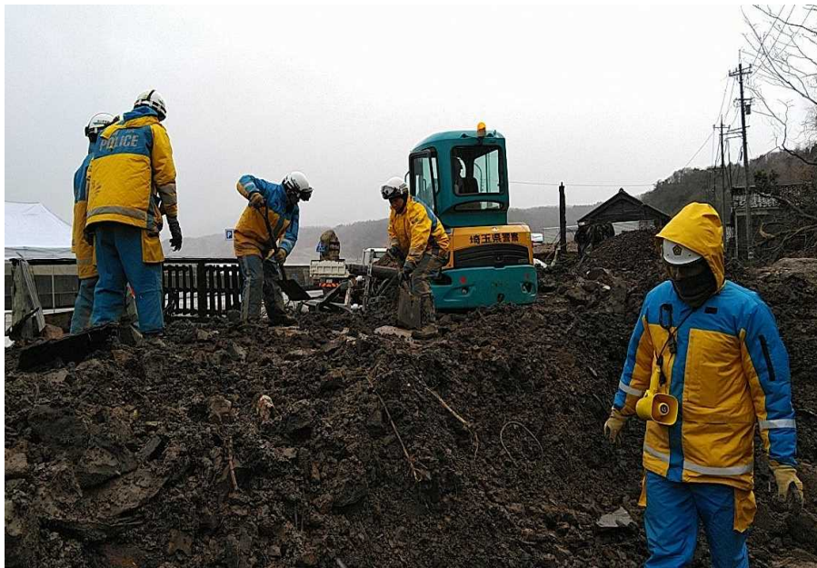
土砂崩れ現場における捜索
