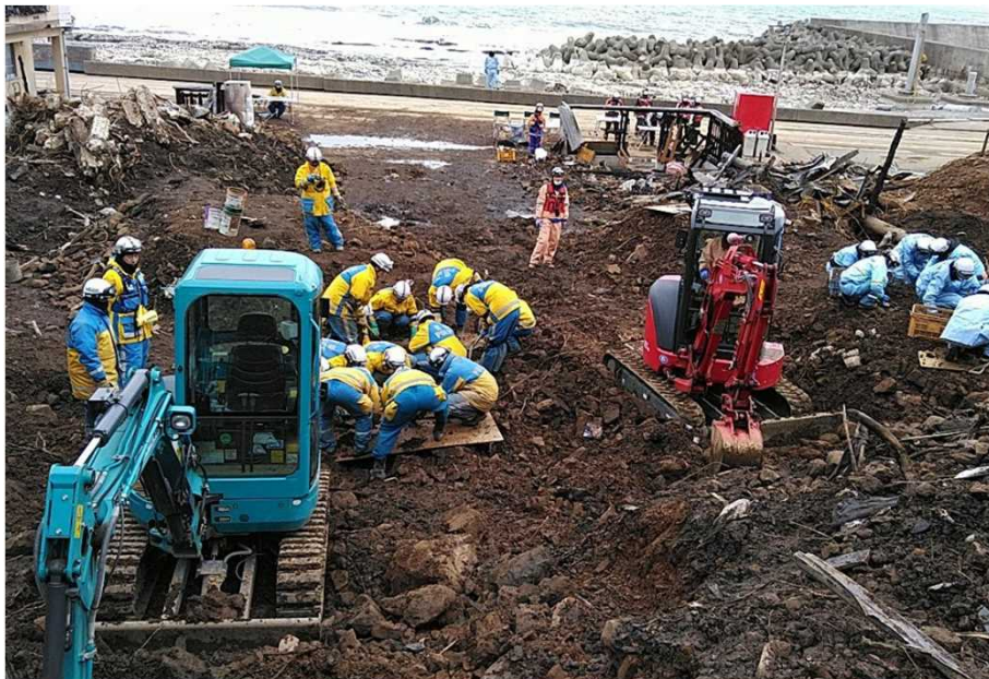
土砂崩れ現場における捜索
