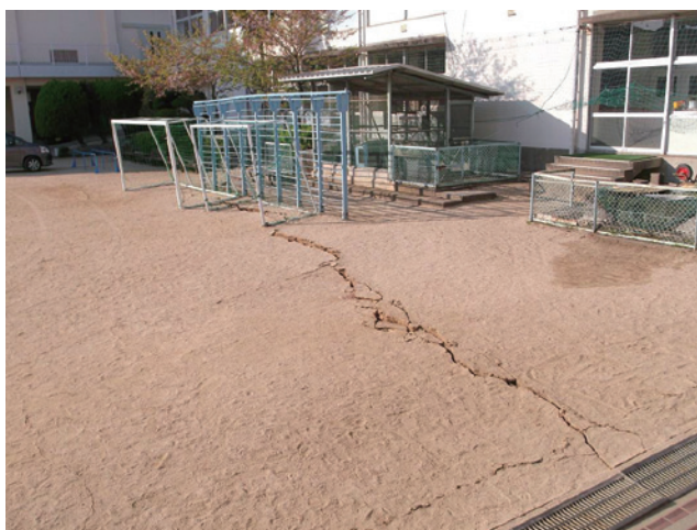
淡路島付近を震源とする地震の被害状況（兵庫）
