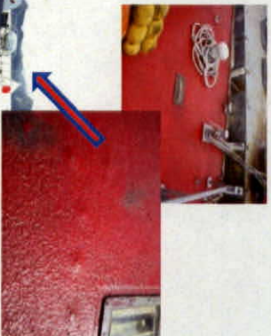
甲板内部の腐食
