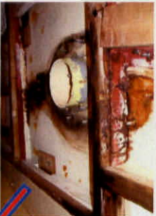
船室天井部の腐食
