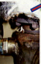
機関室排気管の腐食
