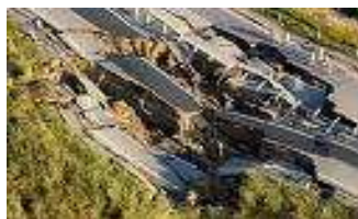
陥没した関越自動車道(堀之内町) (H16.10 新潟中越地震)
