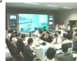
広域交通管制室
